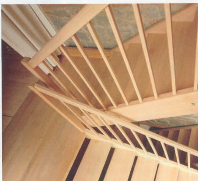
Die Treppe aus weiß geölter Eiche wirkt leicht und filigran, da die Querschnitte so weit wie möglich reduziert wurden
